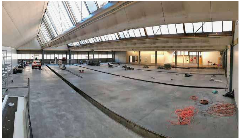
Turnwerk Südostschweiz: In dieser alten Industriehalle werden in Zukunft Sarganserländer Turner üben.
